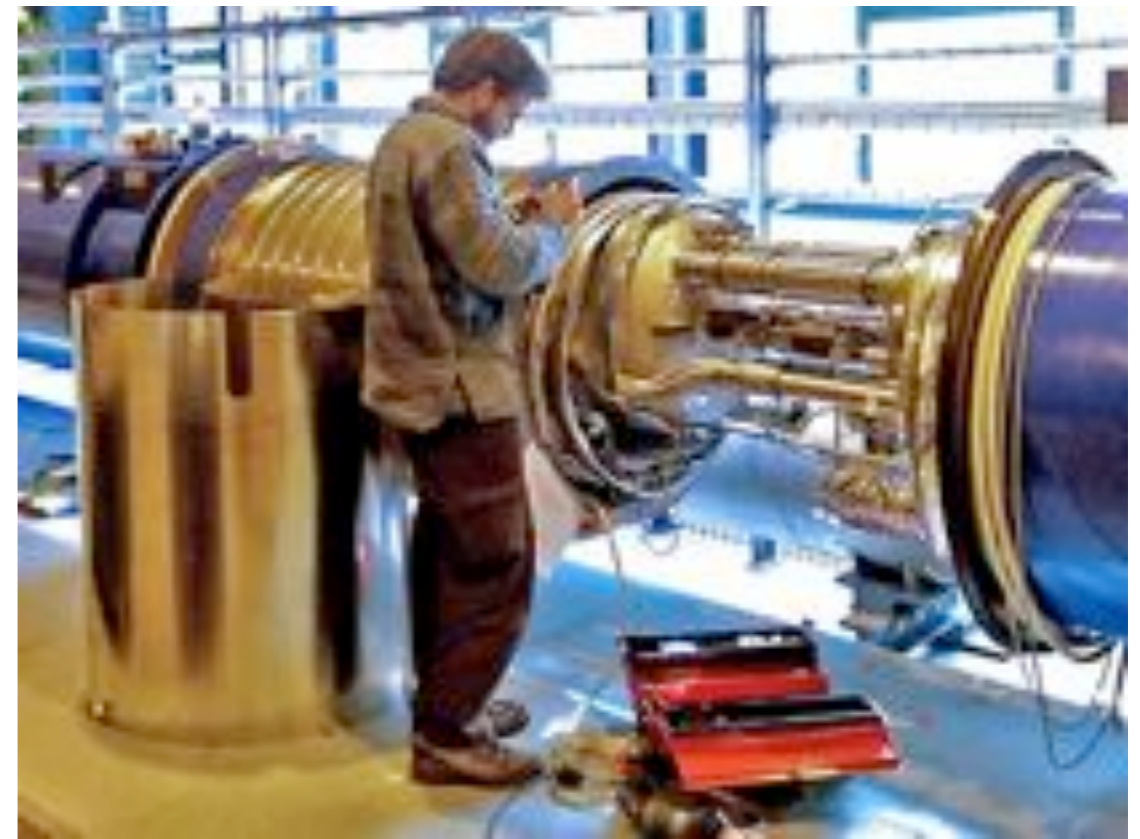
Câblage électrique du LHC au CERN - 2002.
